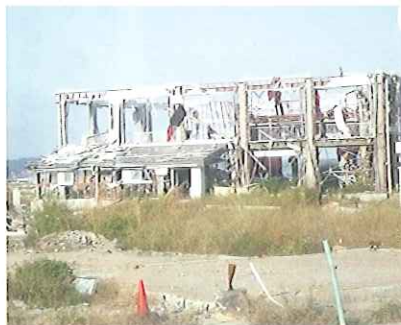
▲骨組みだけが残された建物
