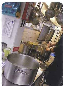
▲オール電化の厨房
